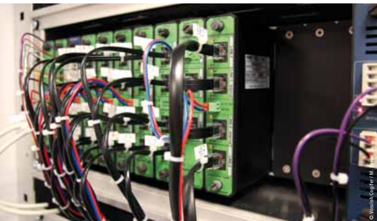
SIEMA digital switch in Villeurbanne, France
